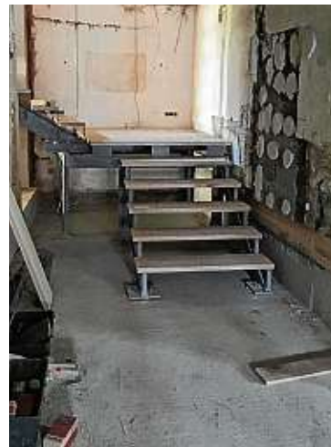
Während der Bauphase zeigte sich den Handwerkern dieses Bild..
